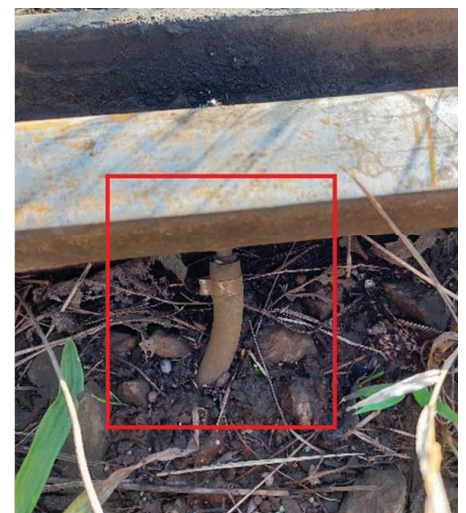
1. Przewód doprowadzający smar, widok od strony zewnętrznej toru, Pętla Klecina we Wrocławiu, materiały własne, 19.09.2025 r.
