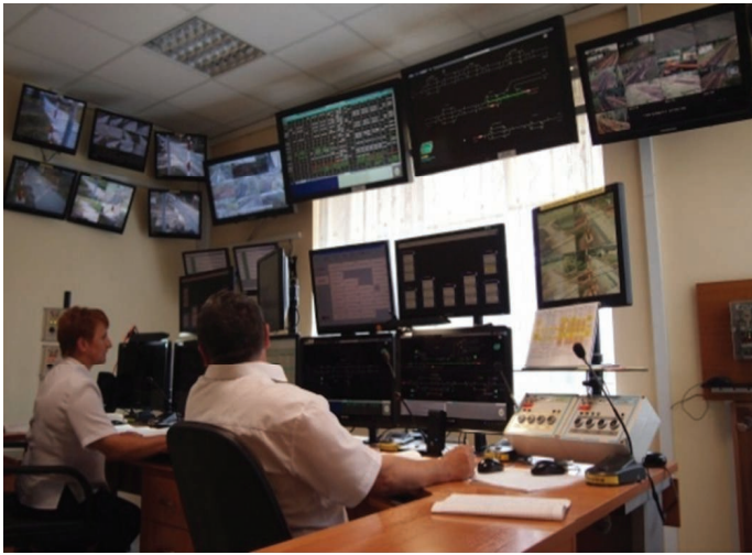
6. Wyposażenie LCS Drzewica w nowoczesne rozwiązania prowadzenia ruchu kolejowego
