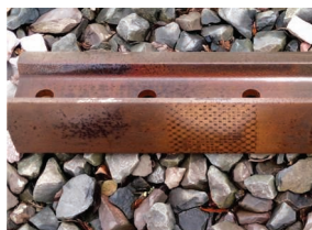
Na okładce: Korozja szyn Źródło: Józef Dąbrowski
