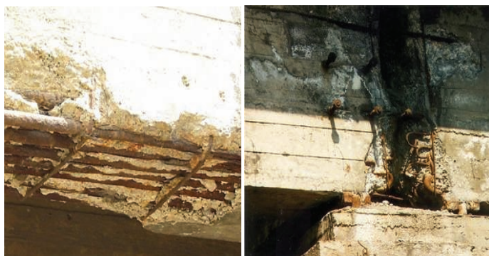
12. Ubytki betonu warstw zabezpieczających oraz ubytki stali zbrojeniowej dźwigarów mostowych
