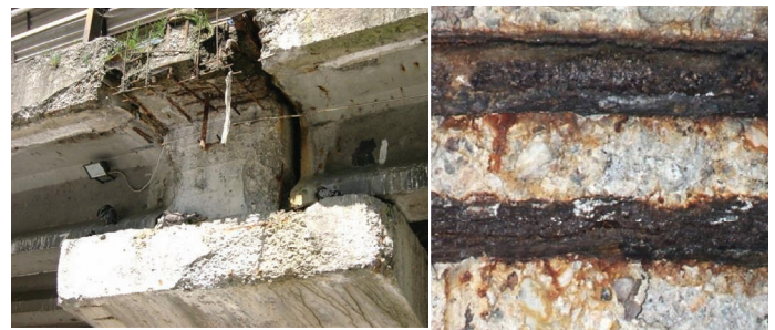
11. Destrakcja betonu i stali prętów zbrojenia w postaci pogorszenia cech chemicznych i fizycznych materiałów – występująca równocześnie z ubytkami materiału
