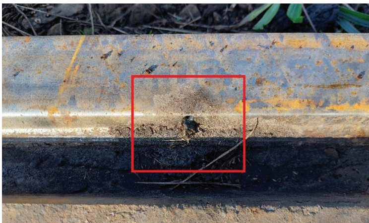
2. Przewód doprowadzający smar, widok od strony wewnętrznej toru, Pętla Kleci-na we Wrocławiu, materiały własne, 19.09.2025 r.
