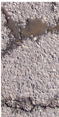
2. Pęknięcia siatkowe, blokowe i liniowe – uszkodzenie nawierzchni asfaltowej polegające na jej spękaniu wskutek wytworzenia się wysadzin pod nawierzchnią; widoczne wykroplenie roztworu z lodu zalegającego w podbudowie; roztwór z rozpuszczonego lodu zalegającego w podbudowie wydostaje się na górną powierzchnię nagrzanej od promieniowania słonecznego nawierzchni pod wpływem grawitacji i obciążenia zewnętrznego
