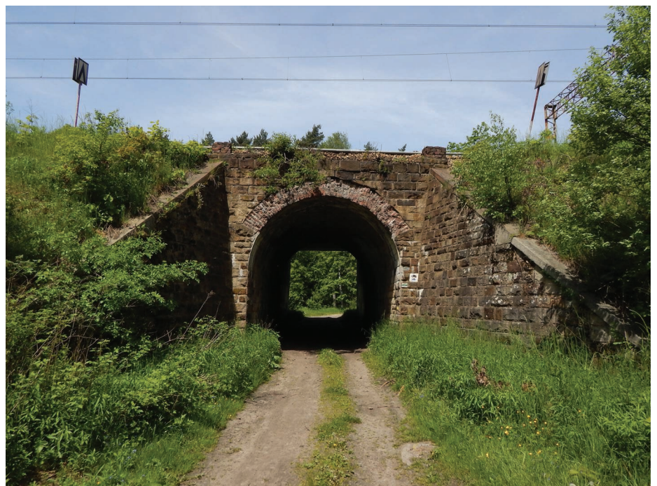
1. Nieprawidłowo zabezpieczony obiekt przed upadkiem z wysokości
