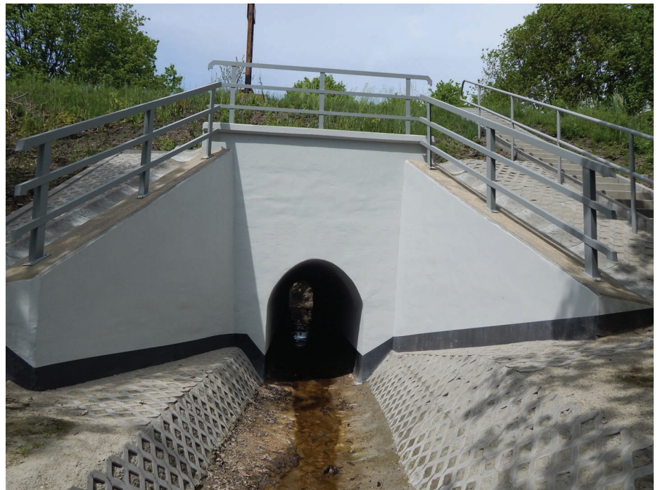
2. Prawidłowo zabezpieczony obiekt przed upadkiem z wysokości
