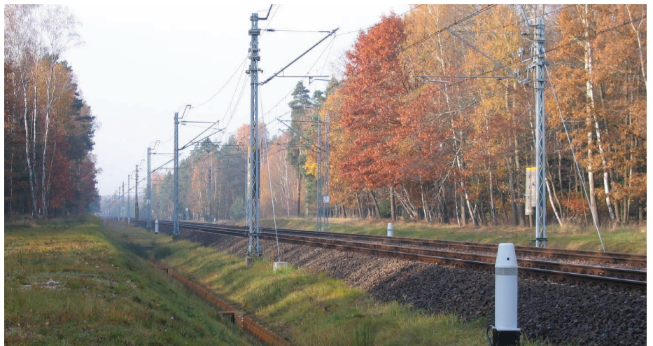
1. Urządzenia Ochrony Zwierząt UOZ-1 na linii E30 odcinek Węgliniec – Bielawa Dolna. Źródło: NEEL
