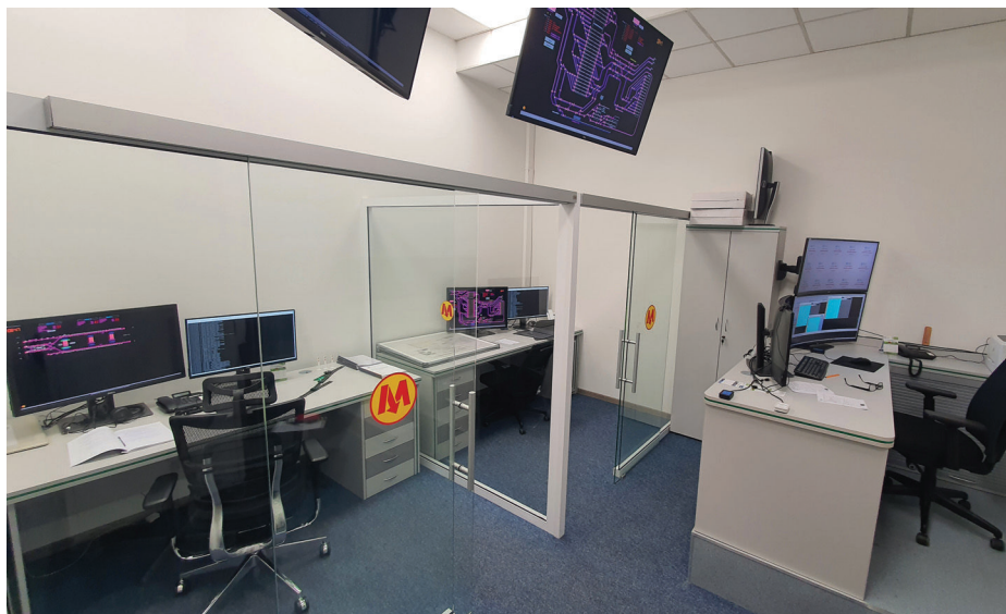
3. Pomieszczenie symulatora stanowiska prowadzenia ruchu, widok na dwa stanowiska dyżurnego ruchu i stacji oraz stanowisko instruktora
