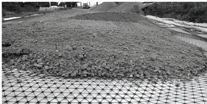
10. Układanie pierwszej warstwy georusztu trójosiowego w trakcie modernizacji linii E65 na obszarze LCS Gdańsk
