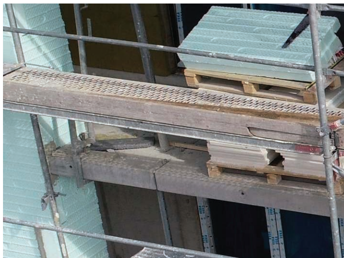
5. Widok na uszkodzoną deskę krawężnikową
