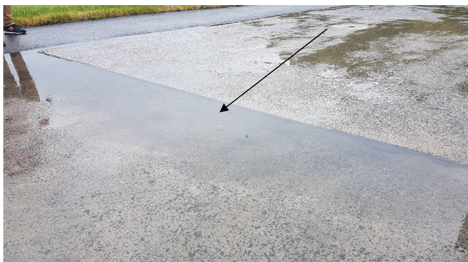
5. Widok obniżenia krawędzi płyty na stanowisku postojowym (zalana wodą) – szczelina oznaczona nr 2
