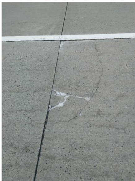
1. Obłamanie krawędzi płyty w wyniku osiadania
