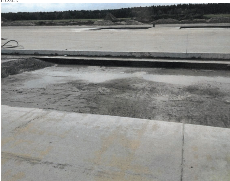
5. W miejscu przeznaczonym na ułożenie mieszanki betonowej zalega warstwa wody
