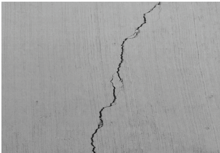
6. Technologiczne pęknięcie płyty nawierzchni betonowej powstałe kilkanaście godzin po ułożeniu mieszanki betonowej
