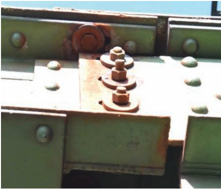
4. Przegub w pasie górnym dźwigara kratownicowego: widoczne pęknięcie blachy górnej spowodowane nadmiernym przemieszczeniem/ obrotem pasa oraz korozją połączenia.
