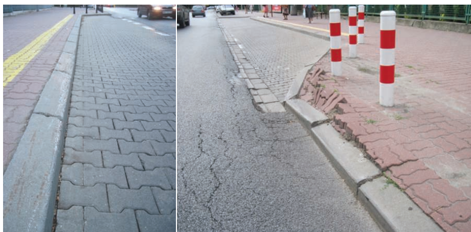
2. Uszkodzenia zatoki i peronu przystanku wywołane uderzeniami pojazdów - otarcia i ukruszenia krawężnika oraz zniszczenie zbyt „ostrego” skosu wjazdowego zatoki
