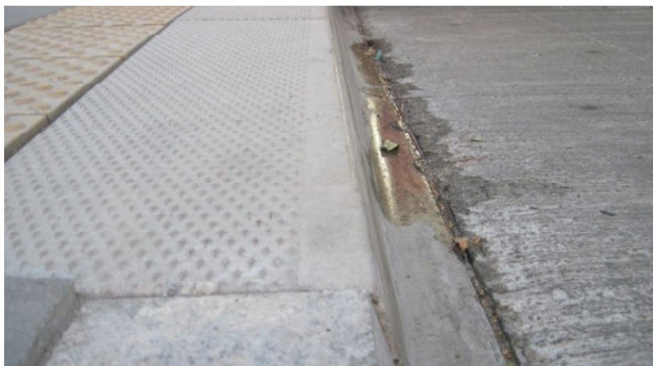
3. Krawężnik peronowy z wysuniętą w kierunku jezdni dolną częścią oraz zaokrąglonym połączeniem z częścią pionową i zaokrągloną krawędzią górną, co ułatwia podjeżdżanie pojazdem pod peron bez pogorszenia stanu technicznego pojazdu i krawężnika
