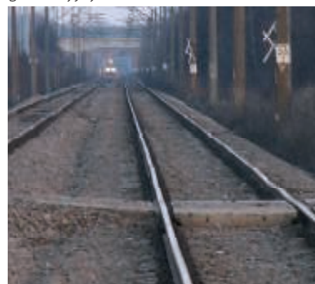
1. Fragment linii kolejowej o silnie zdeformowanych torach
