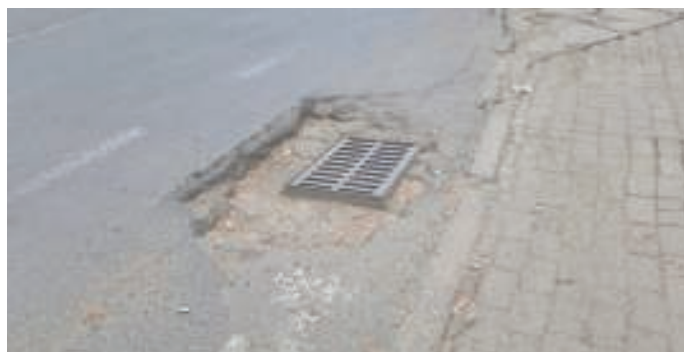
2. Odsłonięte studzienki kanalizacyjne i ubytki asfaltu (Międzyodrze / Wyspa Pucka). Źródło: opracowanie własne
