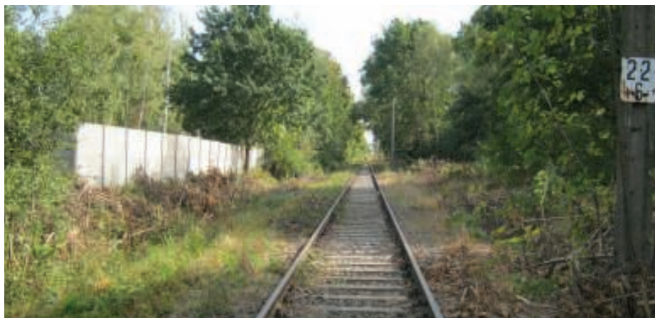
1. Linia kolejowa nr 292 na odcinku pomiędzy stacjami Wr. Sołtysowice i Wr. Osobowice
