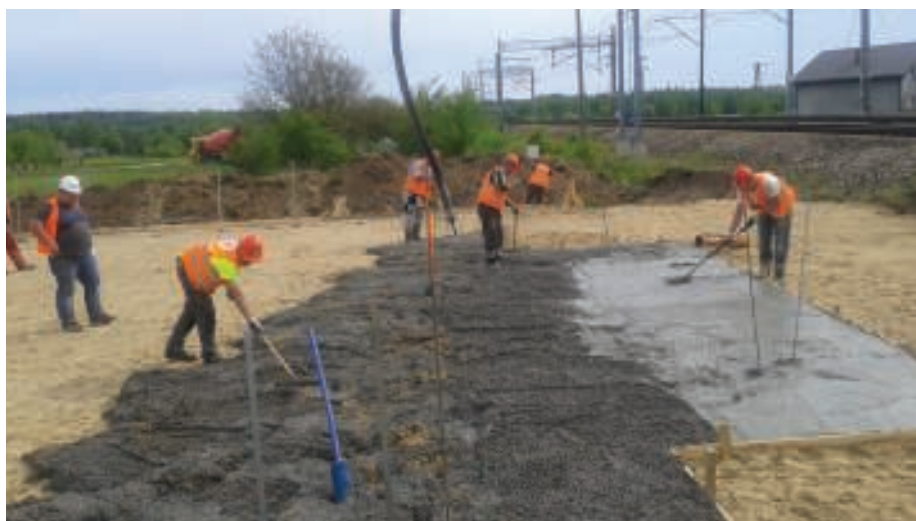
11. Betonowanie podkładu pod maty wibroizolacyjne (zdjęcie udostępnione przez PORR Polska Construction S.A.)
