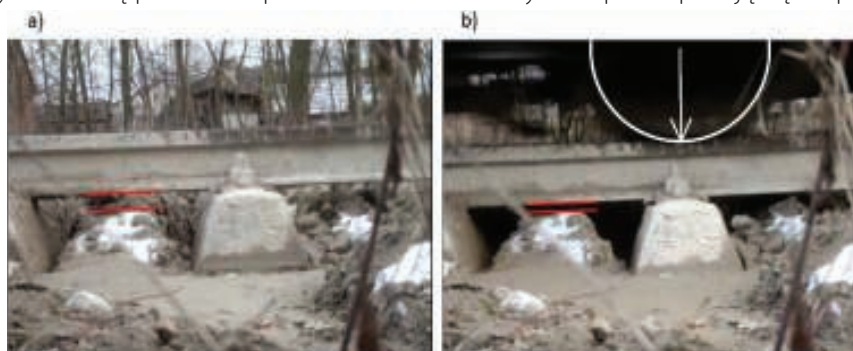
1. Ugięcie toru kolejowego w rejonie wychłapek
