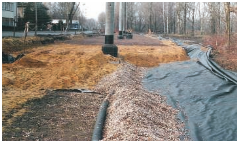
4. Rozwiązanie typu „kanapka” z geosyntetykiem i odwodnieniem, pod klasyczne tory niezabudowane (ul. Kwidzyńska 2000)
