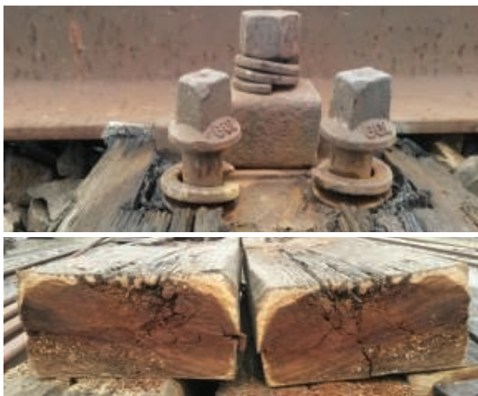
11. Degradacja podkładów po 20 letniej eksploatacji
