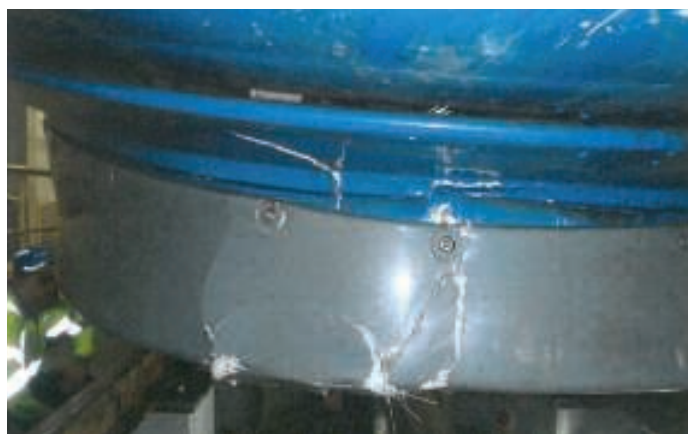
4. Pęknięta obudowa aerodynamiczna i zgarniacz [Kałuża i in. 2015]
