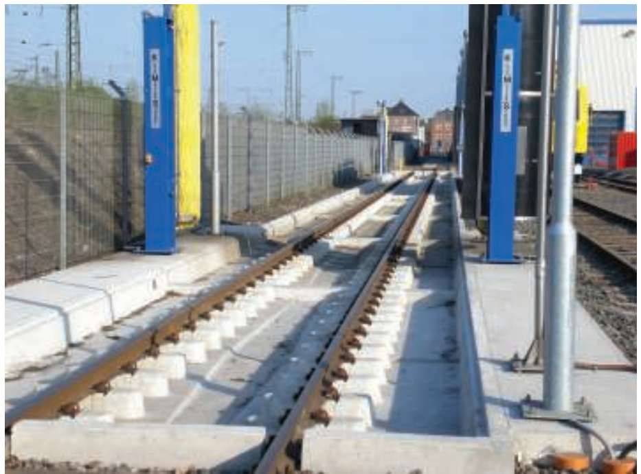
2. Ekologiczny punkt mycia pojazdów kolejowych, wykonany na szczelnych wannach torowych systemu GTW (Fot. BFL Lauchhammer)
