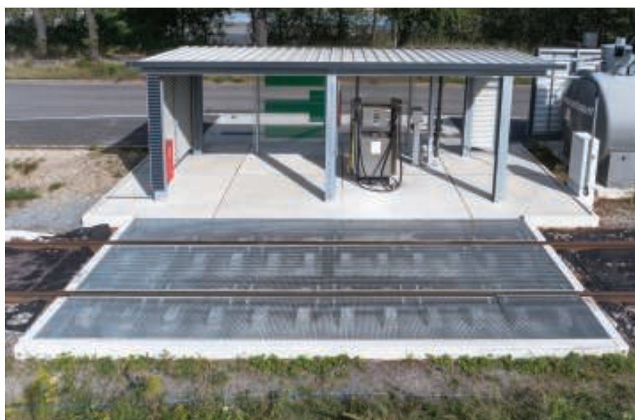
4. Ekologiczna stacja paliw do tankowania lokomotyw, wykonana z nawierzchni bezpodsypkowej prefabrykatów żelbetonowych sytemu GTW
