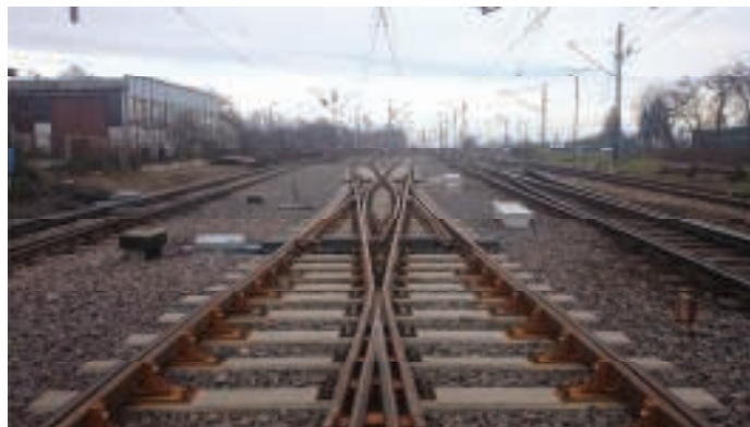
11. Widok zabudowanego rozjazdu Rkpd 60E1-190-1:9 firmy Vossloh Cogifer Polska Sp. z o.o. na stacji Świdnik jako rozjazd nr 24
