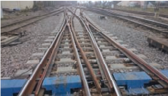
8. Zwrotnica rozjazdu firmy Track Tec KolTram Sp. z o.o. Widoczne rolki podglicowe „Austrollor”.
