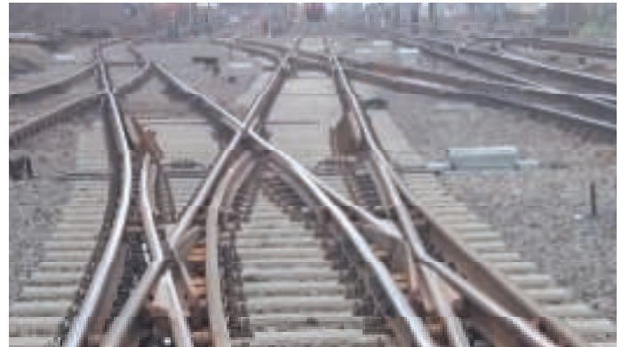
9. Widok zespołu krzyżownic podwójnych oraz zwrotnicy rozjazdu firmy Track Tec KolTram Sp. z o.o.
