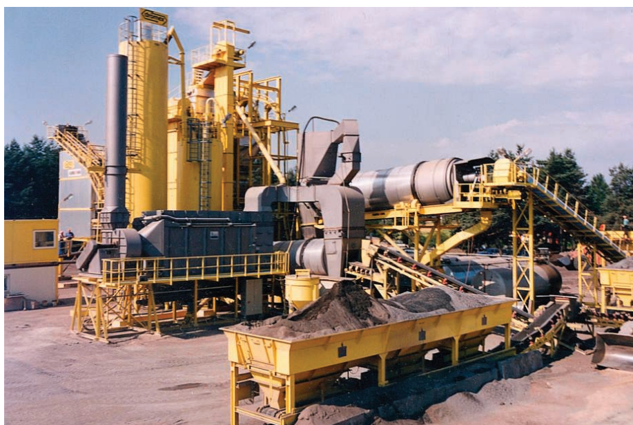
1. Zdjęcie przykładowej wytwórni z bębniem równoległym do podgrzewania granulatu asfaltowego
