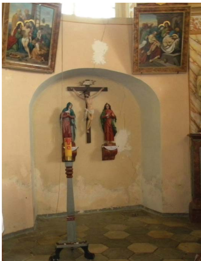
6. Pionowe pęknięcia i zarysowania widoczne na ścianie od strony prezbiterium
