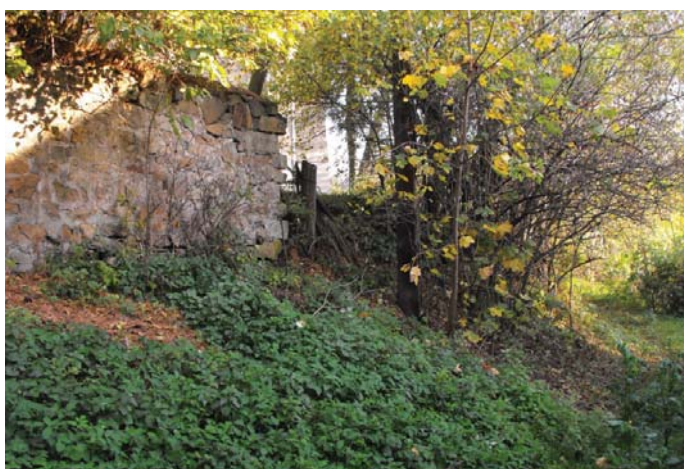
3. Fragment kamiennego muru oporowego oraz zbocza z niestateczną skarpą wzdłuż lokalnej drogi
