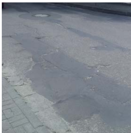
7. Typowe postępujące uszkodzenia nawierzchni asfaltobetonowej
