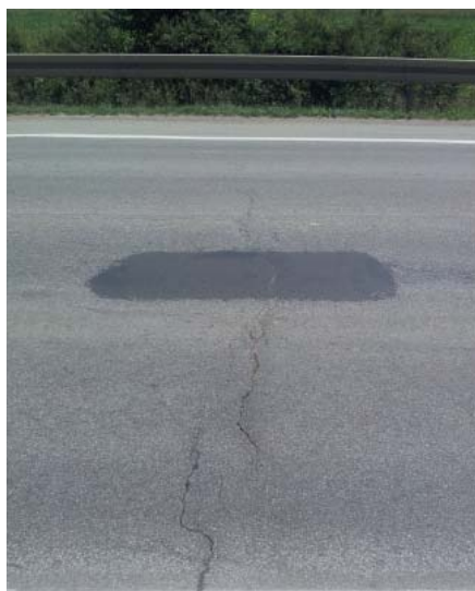
5. Widok typowego uszkodzenia (pęknięcia) nawierzchni asfaltobetonowej
