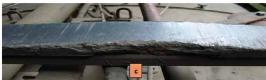
12 a, b, c. Zużycie nakładki węglowej spowodowane wydzielaniem się ciepła w czasie powstania łuku elektrycznego
