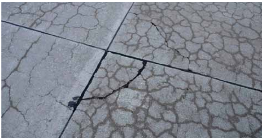
6. Uszkodzenia alkaliczne nawierzchni betonowych
