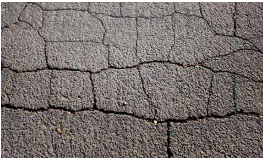
7. Spękania zmęczeniowe w układzie siatki spękań w nawierzchni asfaltowej
