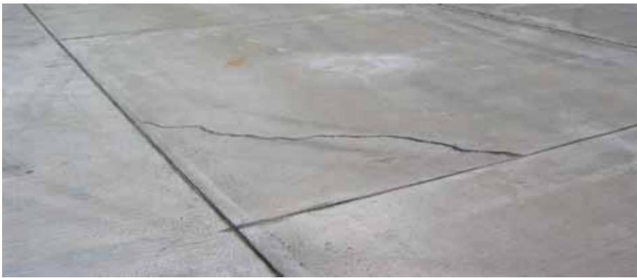
2. Pęknięcie w narożu płyty betonowej
