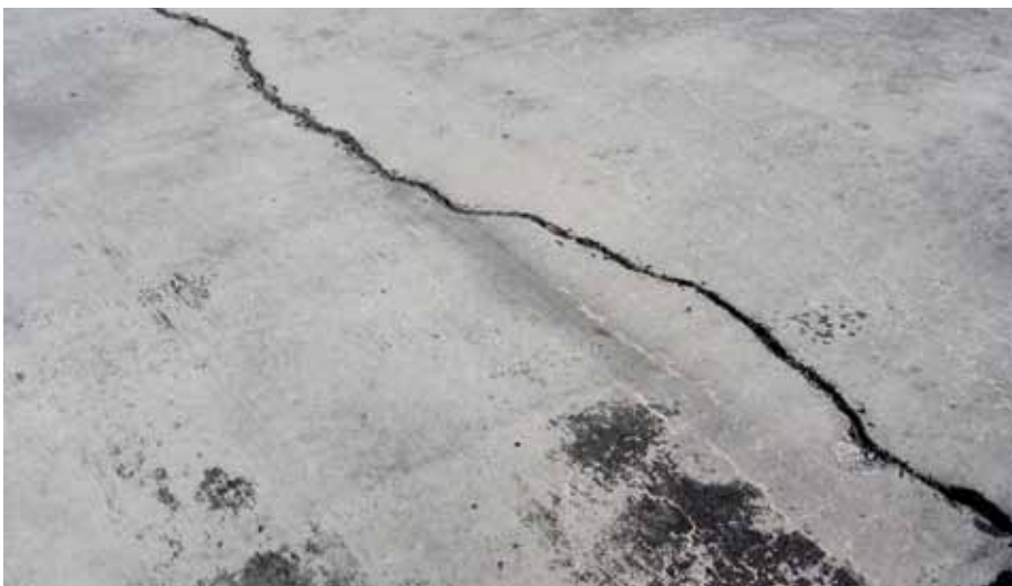
5. Pęknięcie poprzeczne w płycie betonowej
