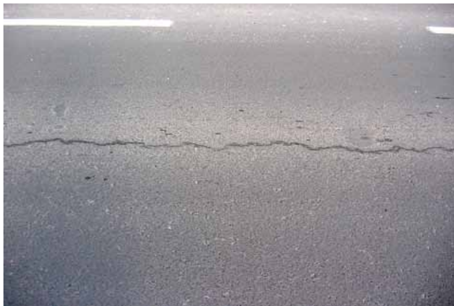
8. Spękanie podłużne w nawierzchni asfaltowej
