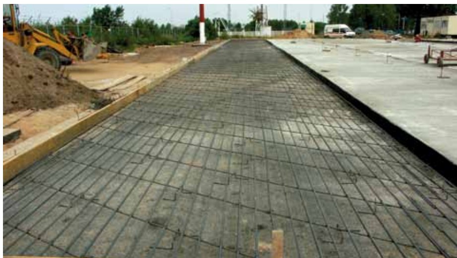
11. Nawierzchnia płyty postojowej o ciętym zbrojeniu na lotnisku w Lublinku
