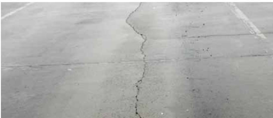
4. Pęknięcie podłużne w płycie betonowej
